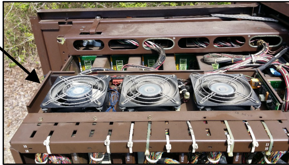
BOOSTER FAN UNIT (BFU)
