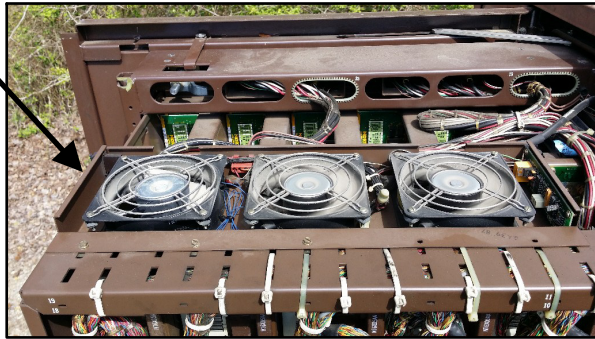
BOOSTER FAN UNIT (BFU)
